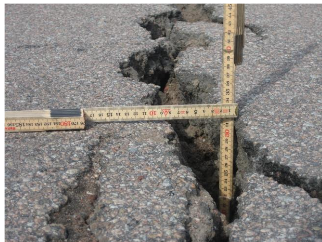
Tjälskador på kommunala vägar
