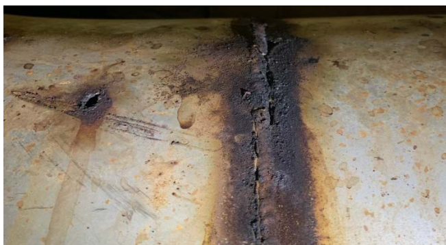
Rostskadat rör, Fagerstahallen
